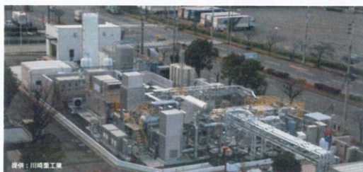
図 1. 水素コージェネレーションプラント
